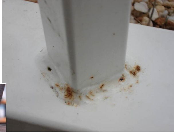
Soudure irrégulière et poreuse Après 2 ans
