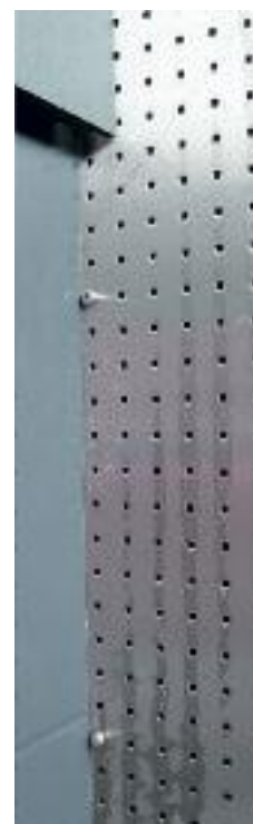
Figure 11 : Pour prévenir la corrosion galvanique, seules des fixations en inox devraient être utilisées sur des panneaux en inox
