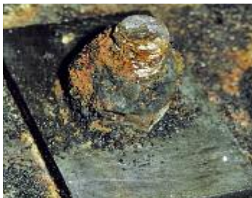
Figure 14 : Corrosion galvanique des fixations en inox d'un bassin de filtrage d'une installation de traitement de l'eau, impliquant des charbons actifs : assemblage (à gauche) et corps de boulon en nuance 1.4016, montrant une perte de section due à la corrosion (à droite)
