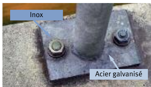
Figure 8a, 8b : Des fixations en inox sur des pièces beaucoup plus grandes en acier galvanisé n'occasionnent normalement pas de corrosion.
